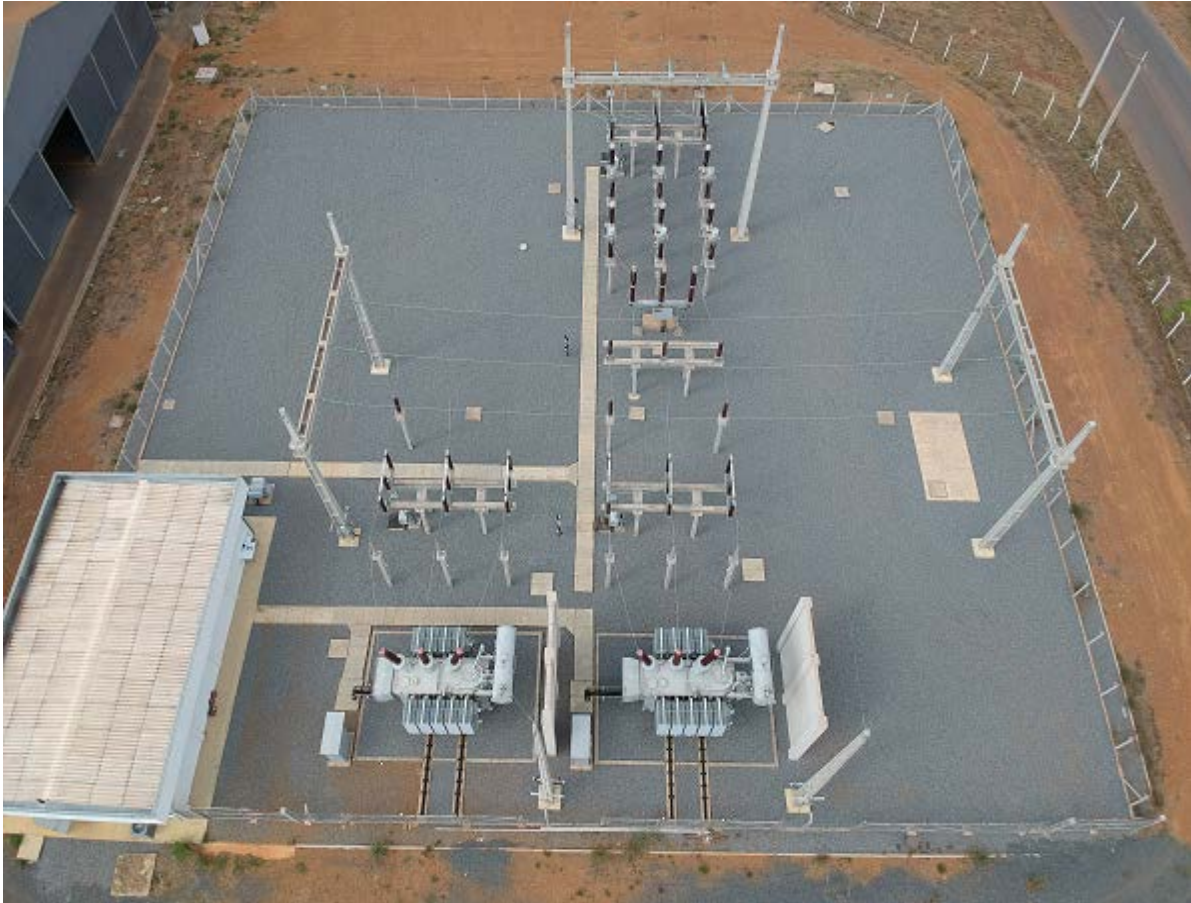
Figura 1 – Vista superior da instalação da subestação
